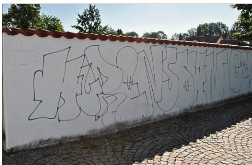
Auch das noch: Graffiti an der Friedhofsmauer.
